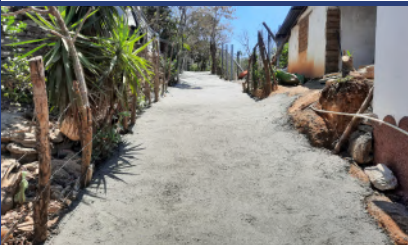
Pavimento en el cruce entre el caserío Los Limones, aldea Ojo de Agua y entrada al Caserío Poco
